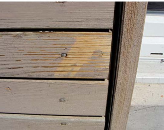
Schäden als Folge unterlassener Pflege- und Unterhaltsarbeiten.
