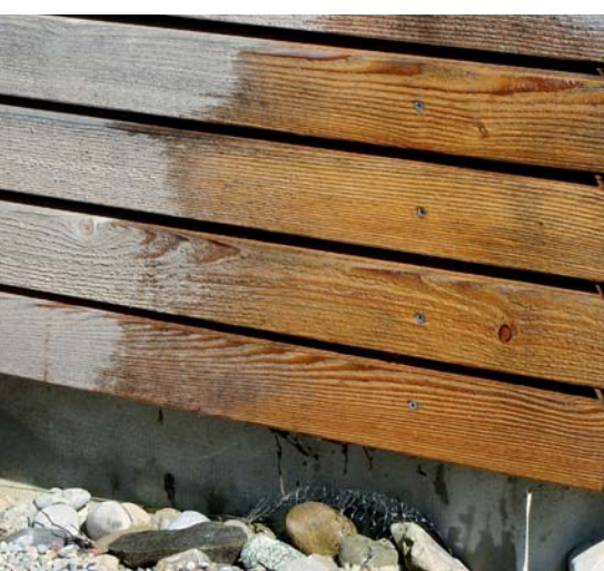
Eine mit Wasser gereinigte Stelle der auf Seite 14 abgebildeten Holzschalung.
