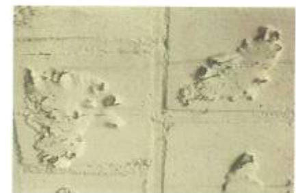
Abdrücken eines Dispersionsanstrichs (ohne Tiefengrund) auf KS-Mauerwerk
