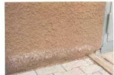
Ausblühungen auf einem Silikatputz infolge aufsteigender Feuchtigkeit!
