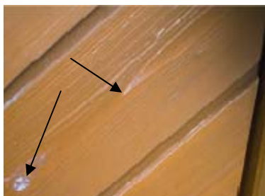
Dickschichtlasur auf Acrylbasis Beginnende Abblätterungen auf den nichtsaugenden Holzflächen (Spätholz, Astlöcher) infolge Schichtbildung der farblosen Holzimprägnierung!
